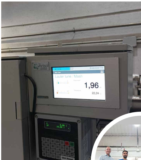
Instalación: Vista principal del controlador de la medición en línea
